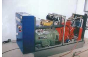
Cogénérateur de chaleur et d'électricité
